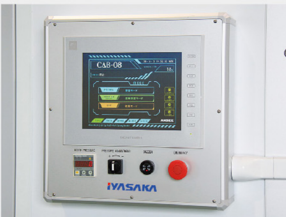
制御盤は、タッチパネル仕様
