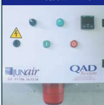
QADs制御盤×1式
