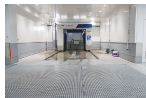
下部洗付門型洗車機は 1 階と 2 階に各 1 台を設備。グレーチングは FRP。
