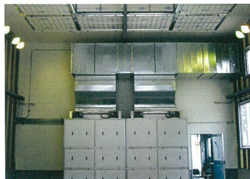
建設機械塗装工場用塗装ブース
