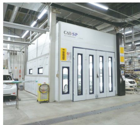
水性塗料対応の塗装ブースCAB-08は2基を設備。
