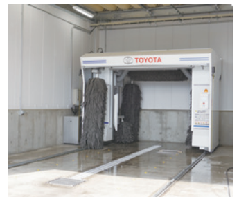
門型洗車機は2基を設備。
