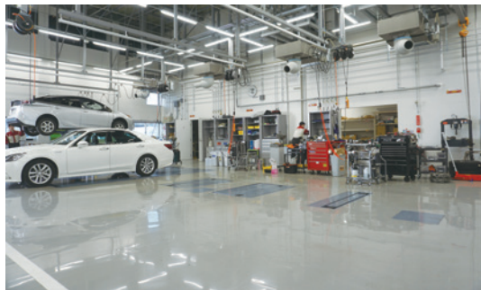
全6ストール（検査ライン含む）のサービスショップにはスポット型のエアコンがストール毎に完備しています。
