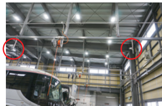
架台に設置した CS-Photo のカメラ。
